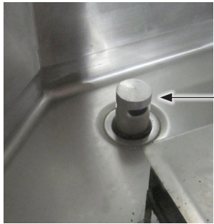
Drain Stand Pipe
