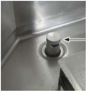
Drain Stand Pipe
