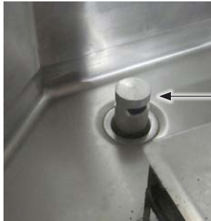
Drain Stand Pipe
